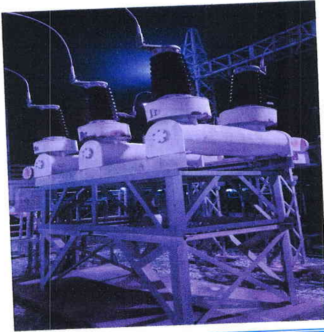
69 kV VCB "MEIDEN Type VBO-60525N Year 1982"
