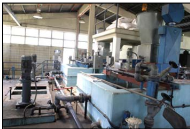
เครื่องผสมสารเคมีต่างๆ ซึ่งจะแยกมาอยู่อีกมุมหนึ่งของโรงงาน
