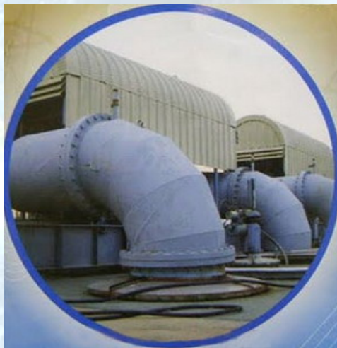
ภาพที่ 1 เครื่องกำเนิดไฟฟ้าโดยใช้การขับเคลื่อนจากพลังน้ำที่ติดตั้ง ณ สถานีสูบน้ำ
