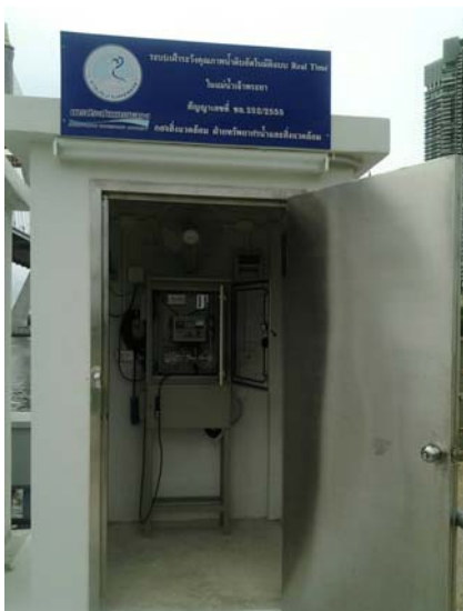
สถานีตรวจวัดคุณภาพน้ำดิบทางไกลอัตโนมัติ
